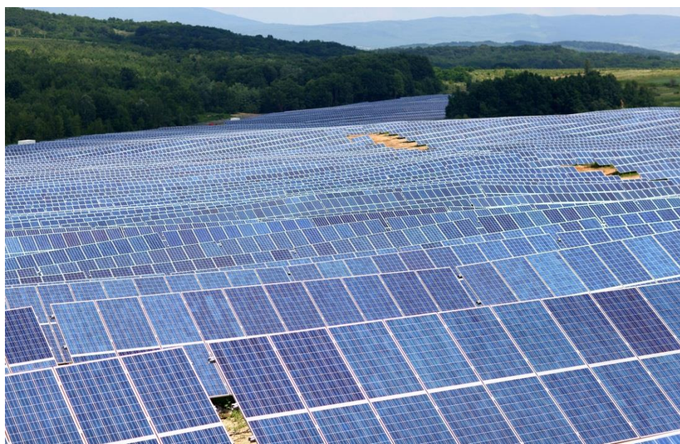
Рис. 2. Сонячна електростанція «СЕ-2» поблизу с. Ірлява Ужгородського району
