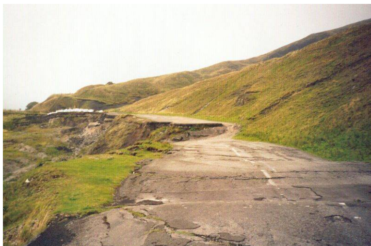
Рис 5. Обвальний процес дороги
