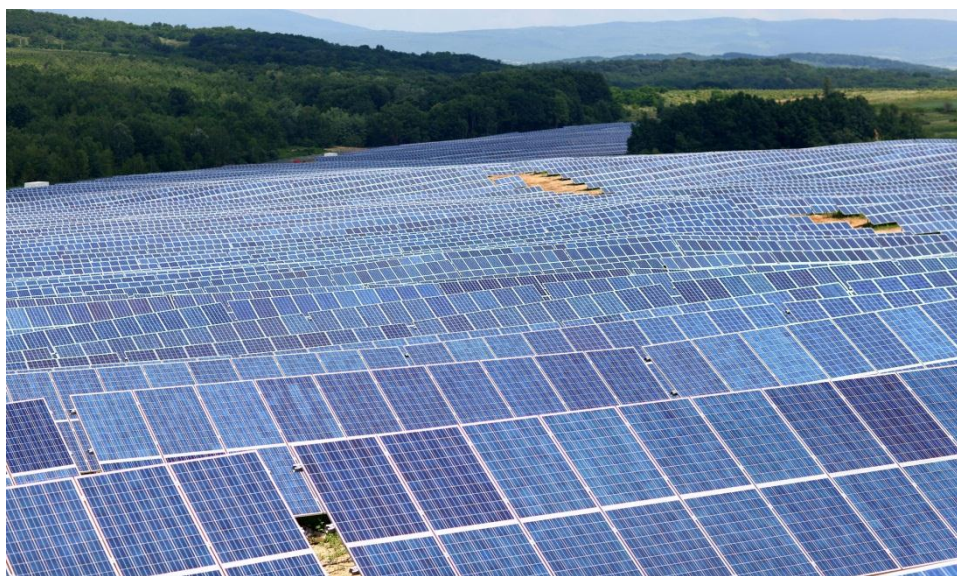
Рис.2. Сонячна електростанція «СЕ-2» поблизу с. Ірлява Ужгородського району .
