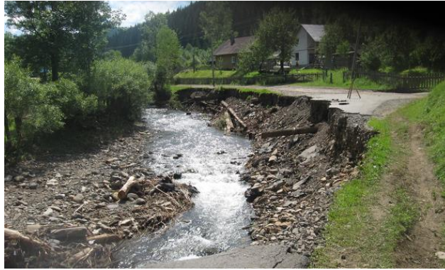
Рисунок 1. Дорога в с. Лопушне, зруйнована боковою ерозією
