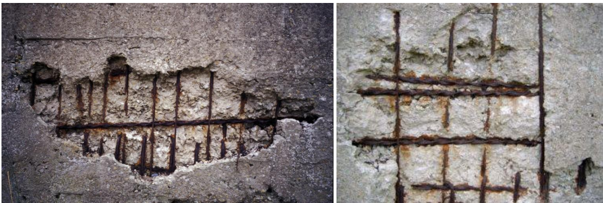
(рис 1-2 Корозія арматури залізобетону)
