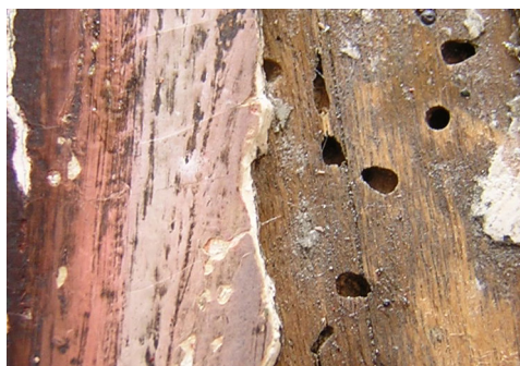
Foto 8 Detaliu-deteriorări cu pierderea stratului pictural
