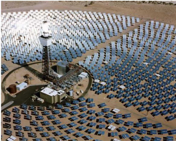
Рис. 9.3. Баштова сонячна електростанція
