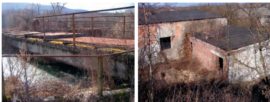
Рис. 1.2.13. Каналізаційно-очисні споруди м. Тячів
