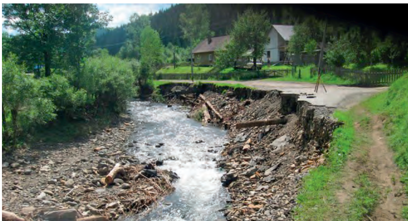
Рис. 10.1.2. Дорога в с. Лопушне, зруйнована бічною ерозією
